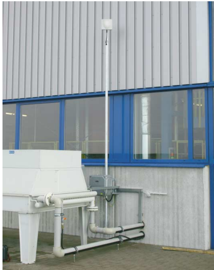
Auf der DSL-Seite der Richtfunkstrecke steht die Antenne in etwa vier Metern Höhe über dem Boden. Die Elektronik ist in einem Schaltkasten am Mastfuß untergebracht.
